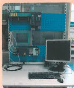
console de supervision par écrans tactiles
