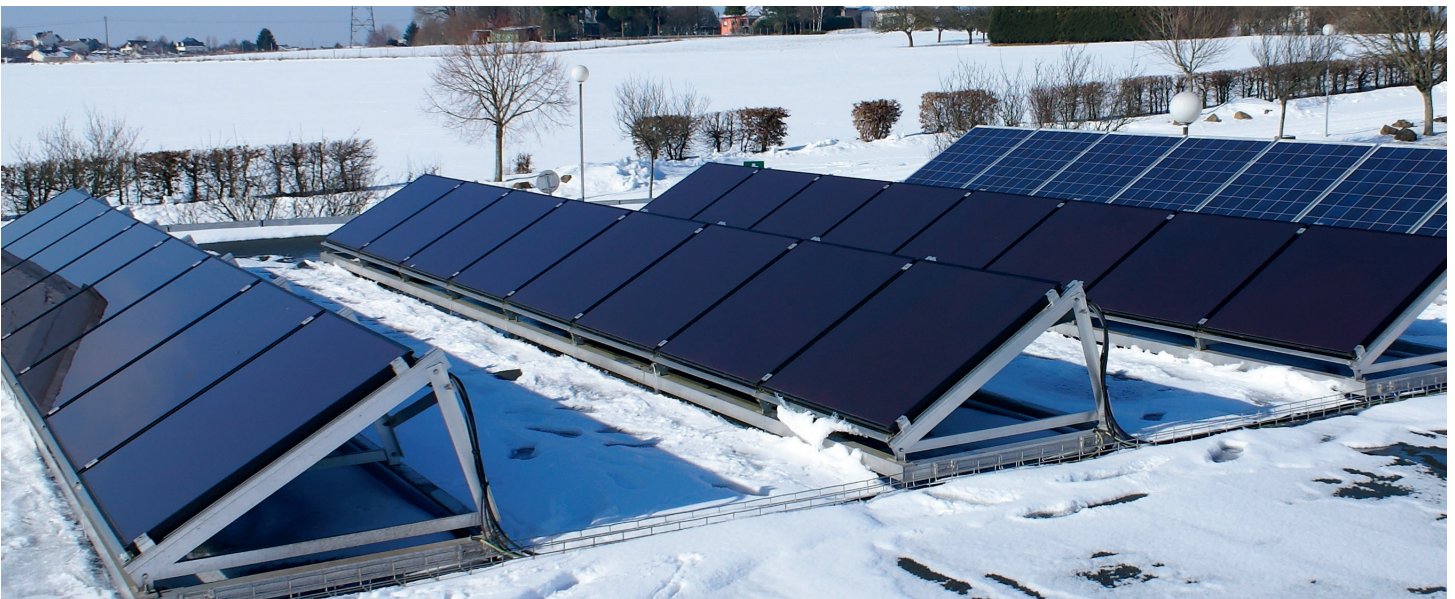
Installation de Panneaux PV sur le toit du département GEII (Source : auteurs)
